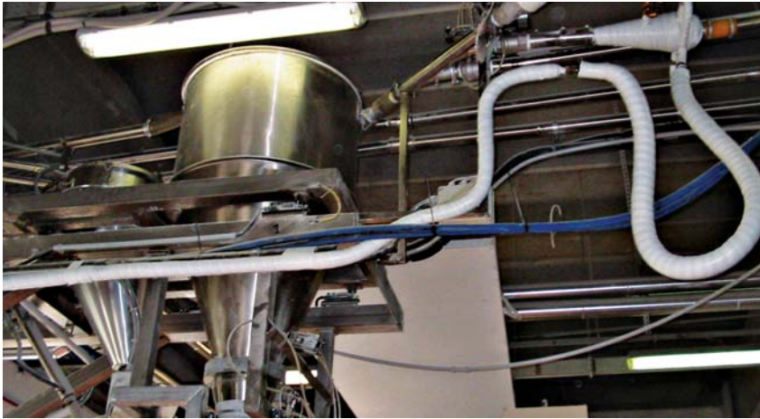
Camera di iniezione dell'azoto
